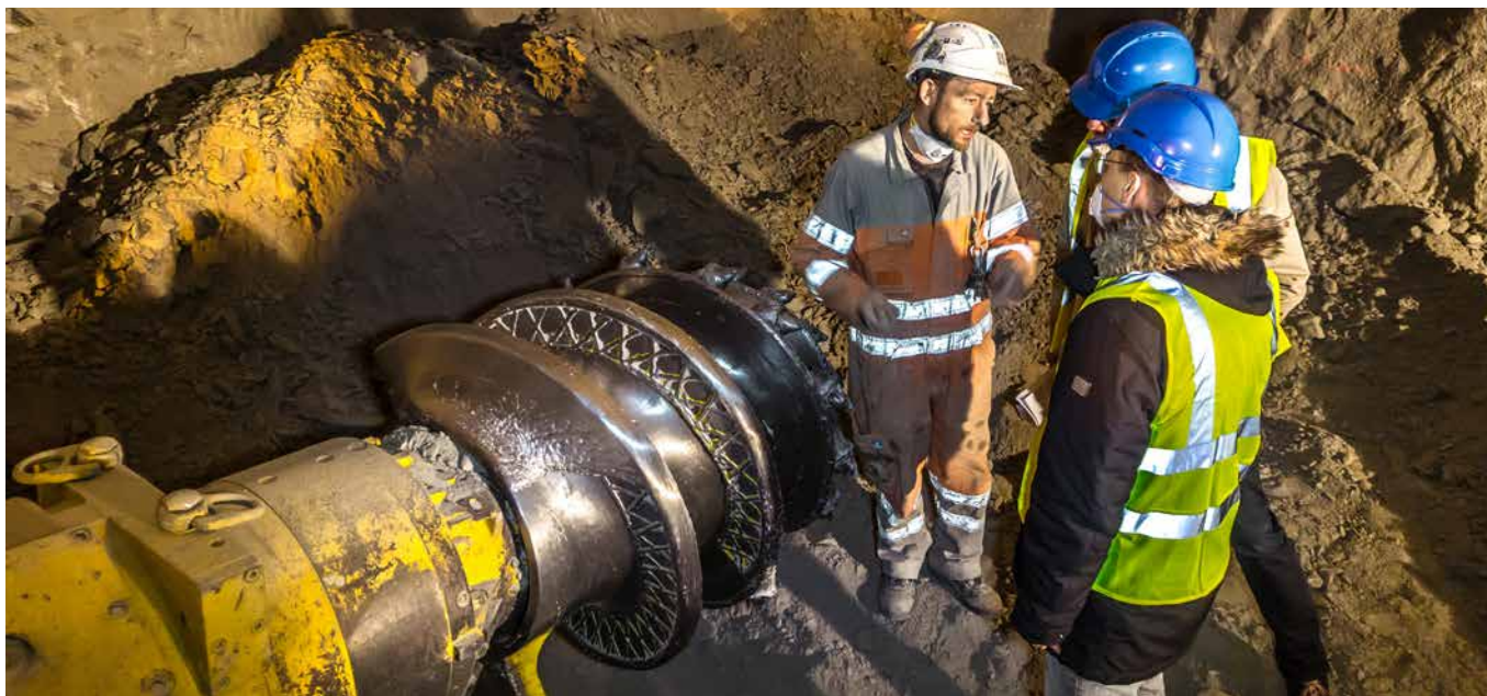
Così si realizza una galleria nell'argilla opalina: l'operatore della fresa meccanica ad attacco puntuale spiega ai visitatori del laboratorio sotterraneo del Mont Terri il suo complesso lavoro. Fotografia: Nagra
