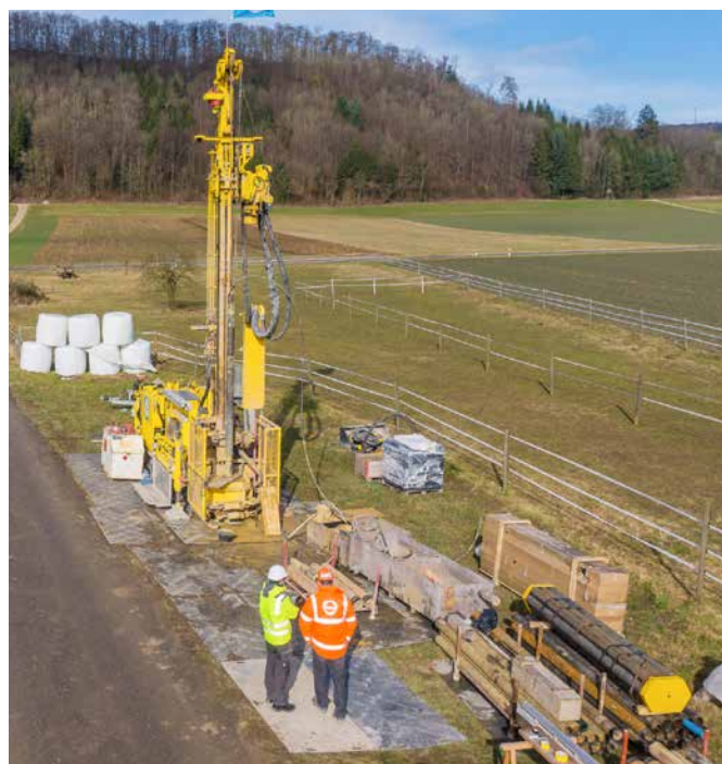
Trivella e cantiere per le trivellazioni nei sedimenti del quaternario a Riniken (AG). Per maggiori informazioni www.nagra-blog.ch . Fotografia: Nagra
