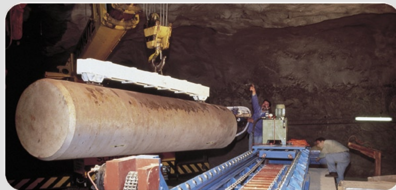
Es wurden zwei elektrische Erhitzer mit gleichem Gewicht und Abmessungen wie die Behälter für abgebrannte Brennelemente (12 Tonnen und 4.5 m Länge) eingebaut.
