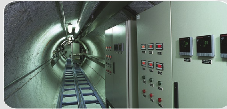
Im Februar 1997 wurden die Erhitzer in Betrieb genommen und daraufhin die Daten mit dem Datenerfassungssystem im Stollen gesammelt und on-line zum Kontrollzentrum in Madrid gesendet. Die Erhitzer werden auf einer Temperatur von konstant 100 °C gehalten.
